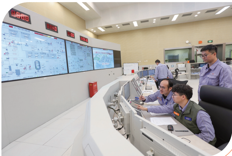
2024年11月13日，在浙江省温州市苍南县中广核浙江三澳核电项目1号机组中控室，工作人员执行冷试操作。这是我国首个民营企业参股投资的核电站 苏巧将/摄
