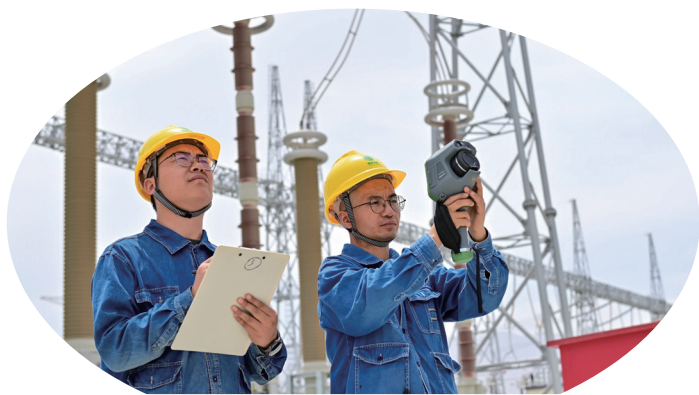
▲在若羌750千伏变电站, 工作人员正检测设备温度 丁磊/摄
